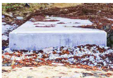
ヒューム管は、土砂が溜まっている
