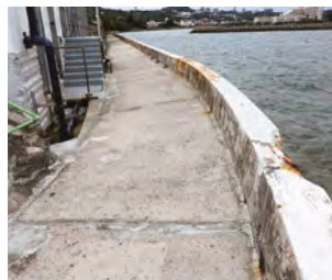
護岸のひび割れ状況
