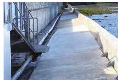
護岸陥没は応急対策で修繕
