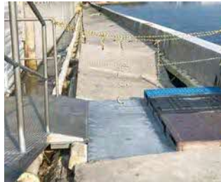
不二宮工業周辺の護岸陥没
