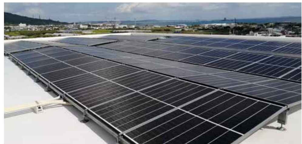
役場庁舎の屋上に設置された太陽光パネル
