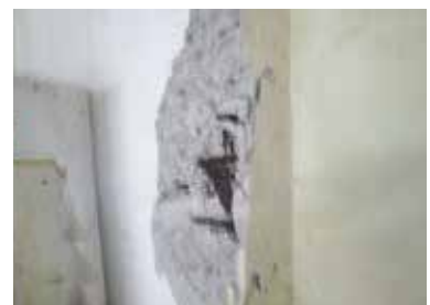
1階部分の支柱:鉄骨が腐食
