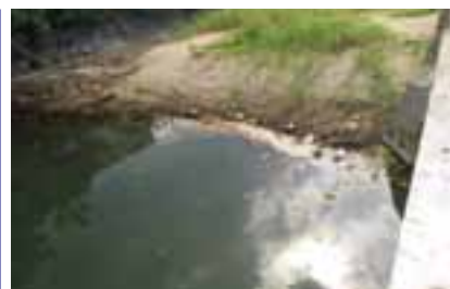
土砂が堆積し、排水できず環境悪化
